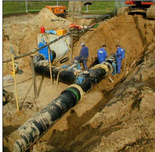
Einführung der Molchstation
