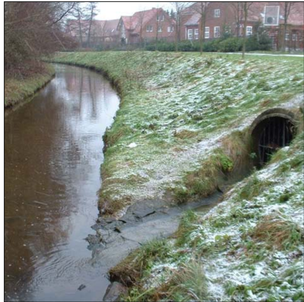
Hydraulische Überlastung des Gewässers durch Einleitungen
